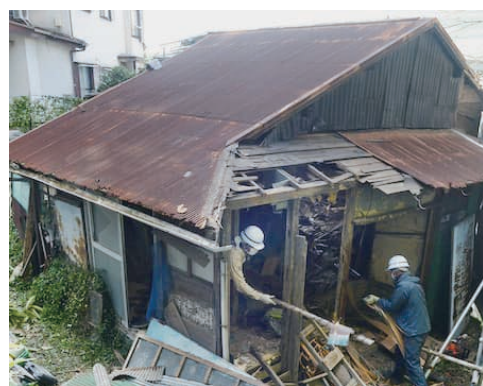
▲全国で空き家が増える中、空き家を放置しにくい環境を整える
